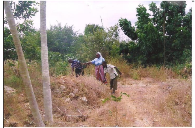
Sr. Anna Muduwa dà indicazioni agli operai per le prime fasi della costruzione.
